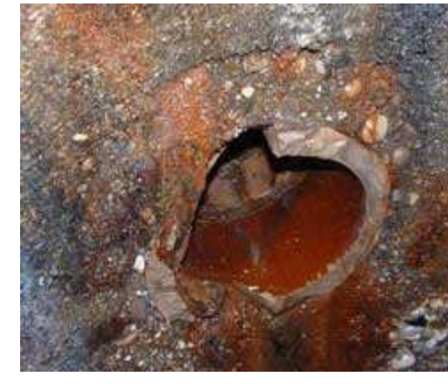
Sichtbare Undichtigkeiten im Anschluss an den Schacht
