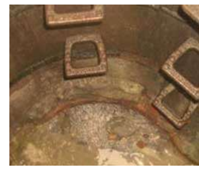
Gerinne und Bankette defekt
