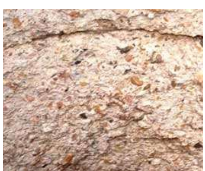
Korrosion der Schachtwandung
